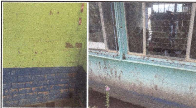
Foto 2: pintura en muros exteriores de la escuela.
